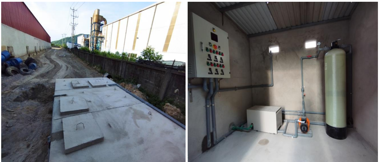
Hình 3. 8. Hệ thống xử lý nước thải sinh hoạt đã xây dựng tại nhà máy
