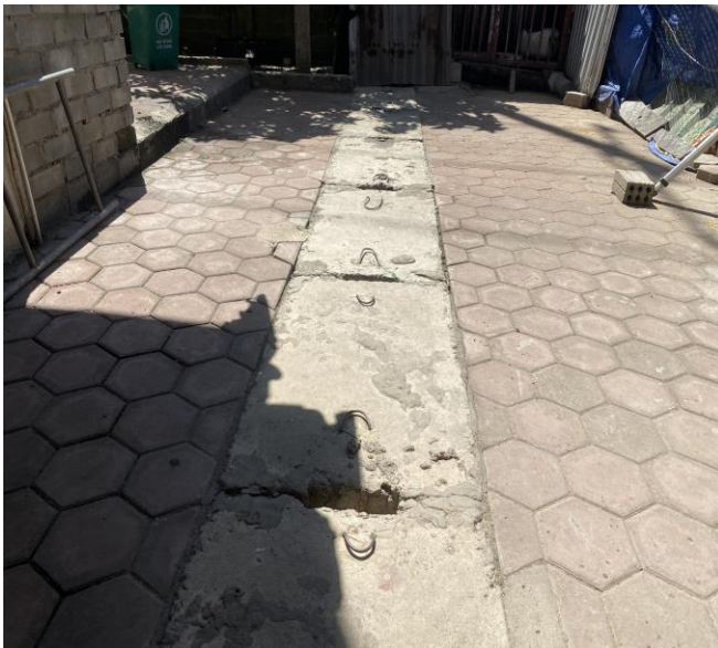
Hình 3. 2. Mương thu gom xung quanh nhà nghỉ ca, nhà ăn
