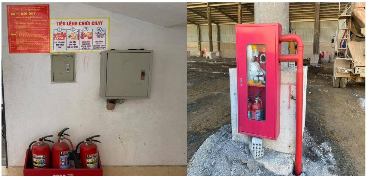
Hình 3. 12. Các công trình PCCC đã được lắp đặt tại nhà máy
